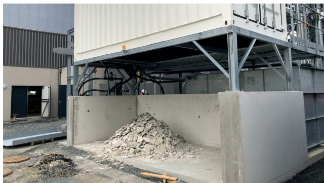
Filtre-presse positionné sur structure métallique, afin de faire tomber les gâteaux en dessous.
